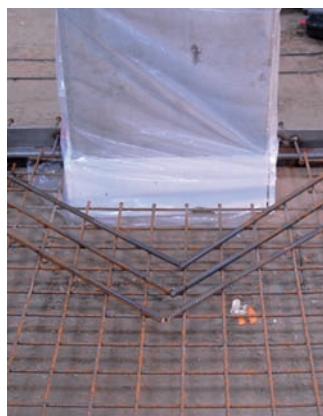
Point singulier de renfort d'armature.
