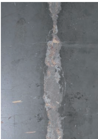
Exemple de joint épaufré.
